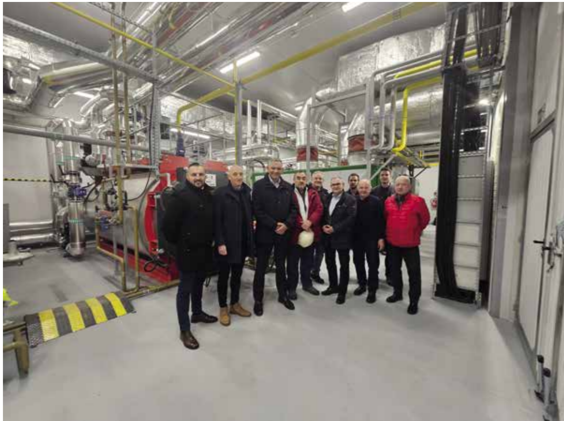
Kotłownia kogeneracyjna to jedna z najnowszych inwestycji USK
